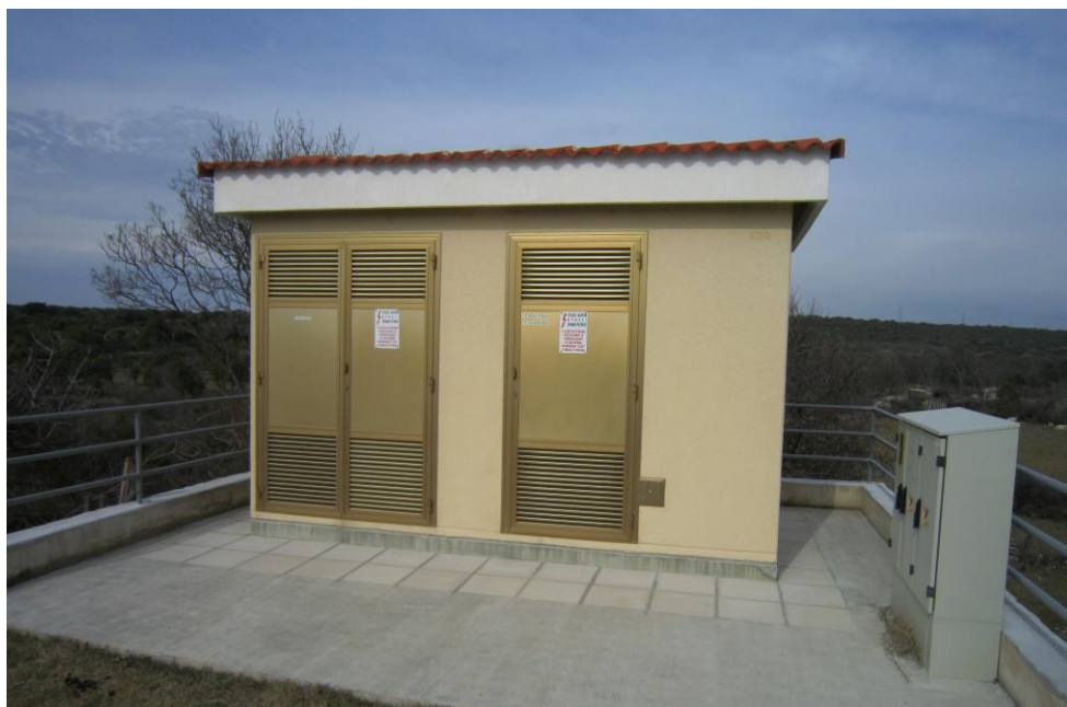
Nova trafostanica TS BELEJ 3 10(20)/0,4 kV (izvan obuhvata plana)
